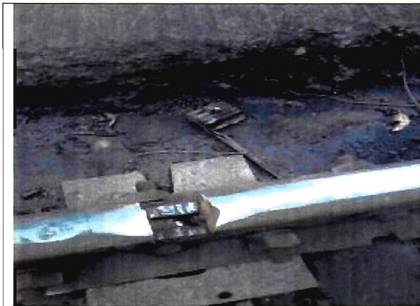
Fractura con desprendimiento Textitlán - Vergel
